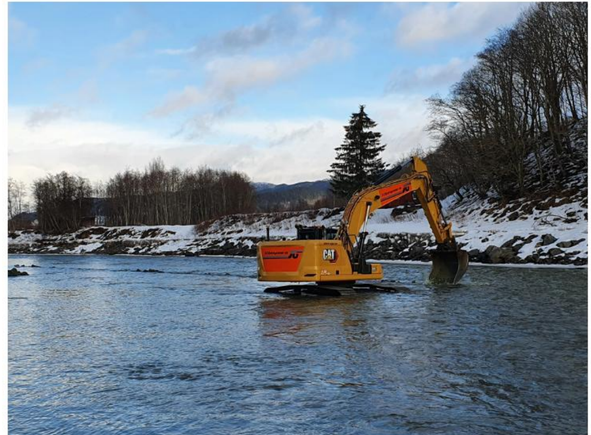
For å bedre gyteforholdene for villaksen i Gaula er det den siste tiden lagt ut mye stein og grus ved Leberg og Hofstadmoen. Foto: Iver Tanem / Statsforvalteren i Trøndelag.
